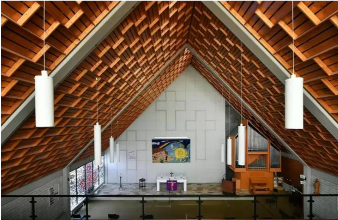
Sanierungsbedarf, insbesondere am Dach: Die 1970 eingeweihte Pauluskirche. Archivfoto: Mehn
